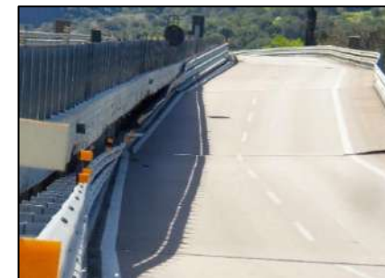
10/04/15_A19 Palermo-Catania (PA) Cedimento delle pile per mov. franoso
