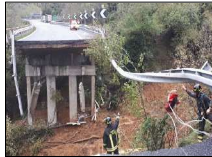
24/11/19_Viadotto A6 Savona - Torino Frana
