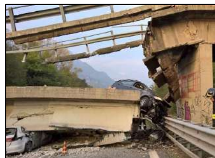
28/10/16_S.P. 49 (LC) Eccessivi carichi verticali
