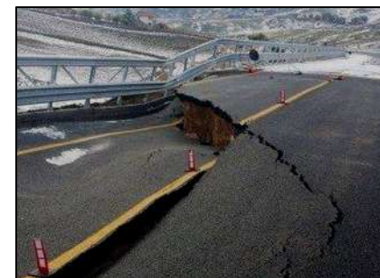
04/01/15_Viadotto Scorciavacche (AG) Cedimento rilevato
