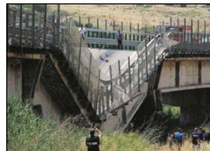
07/14_Viad Petrulla SS262 Ravanusa (AG) Cedimento strutturale
