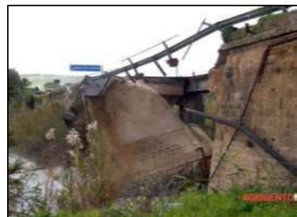
02/02/13_Viadotto Verdura (AG) Cedimento strutturale
