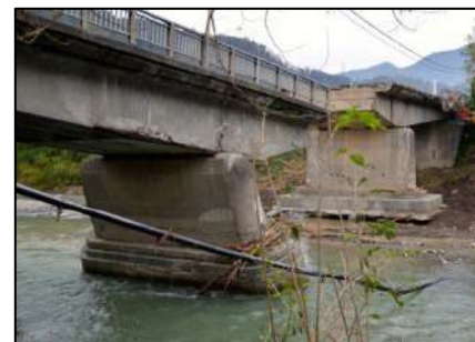
22/10/13_Ponte sullo Sturla (GE) Alluvione
