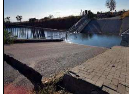
28/08/21_Comacchio (FE) Cedimento strutturale
