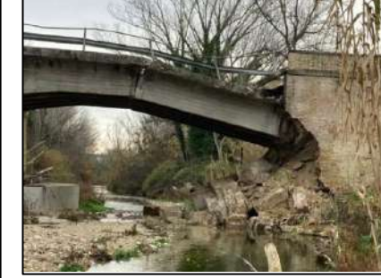
22/12/22_Bellante (TE) Cedimento strutturale
