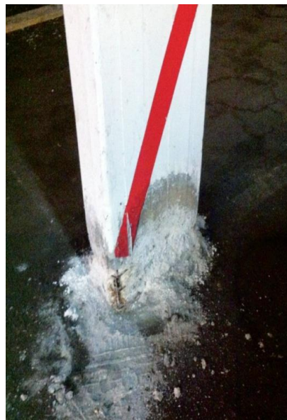
Stadio 2: sezione degradata
