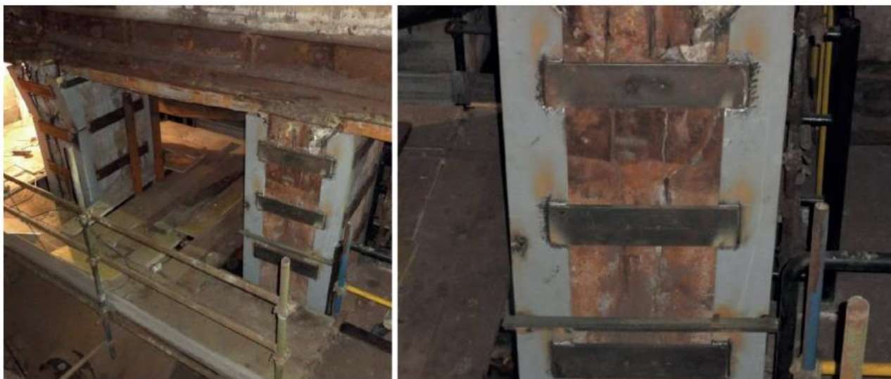
Fig.5 – Rinforzo di pilastri in c.a. di una costruzione industriale mediante cerchiatura in carpenteria metallica
